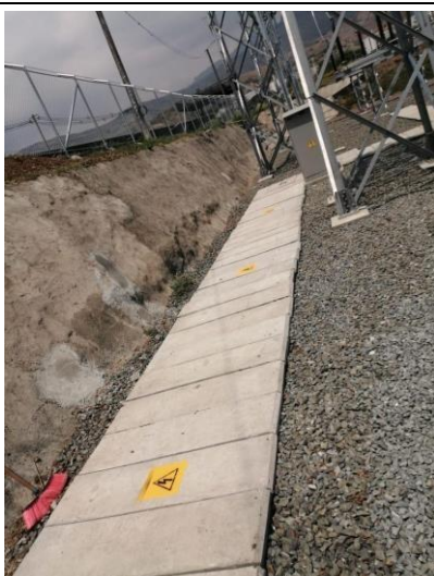
Señalización en cárcamos.
