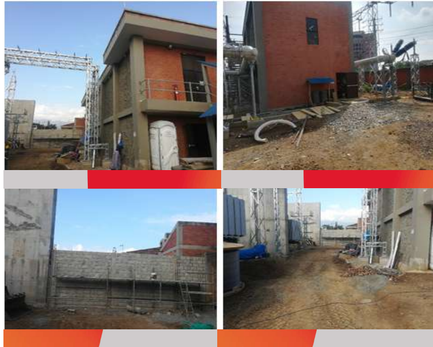
Figura 30. Subestación Diesel II.
